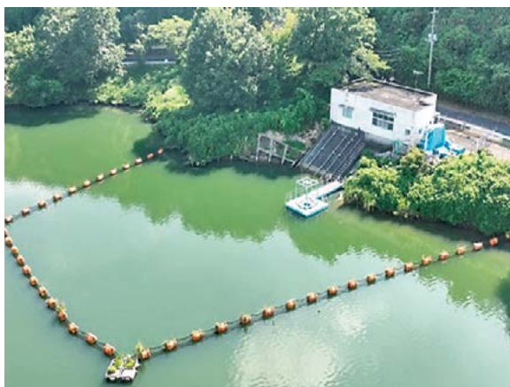
南椎尾調整池 取水設備
