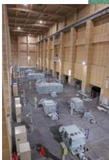
霞ヶ浦揚水機場内部
