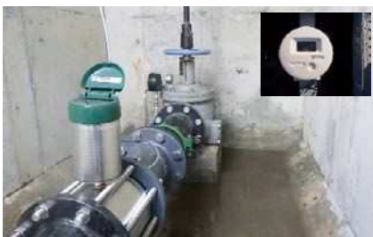
整備後の可変定流量弁および電磁流量計
