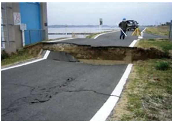
湖岸堤 沈下状況
