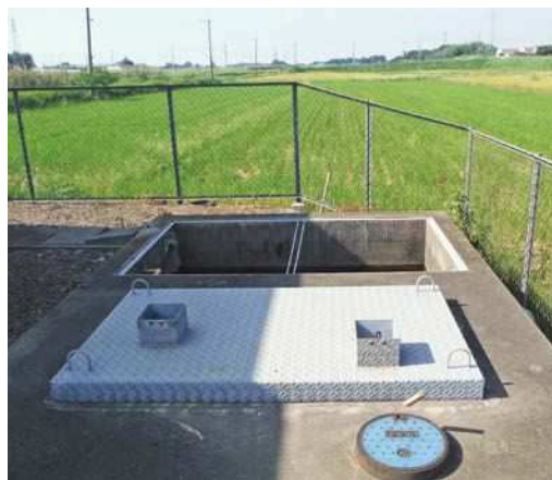
グレーチングおよび縞鋼板蓋が盗まれた施設
