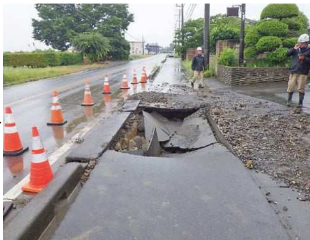
漏水による歩道の陥没状況
