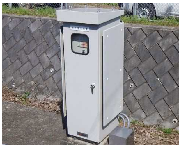
羽黒吐水槽遠方監視装置
