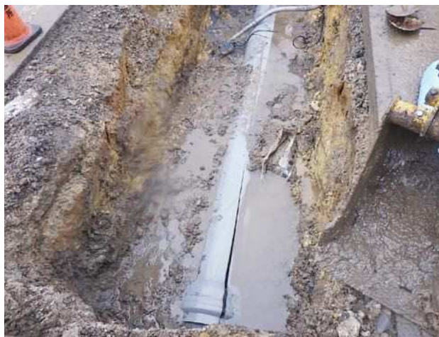
塩ビ管の破損状況(縦割れ)
