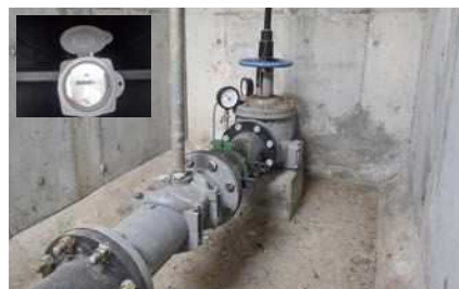
整備前の可変定流量弁および羽根車式流量計
